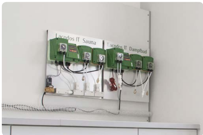
Zařízení pro testování dávkovacích zařízení.
